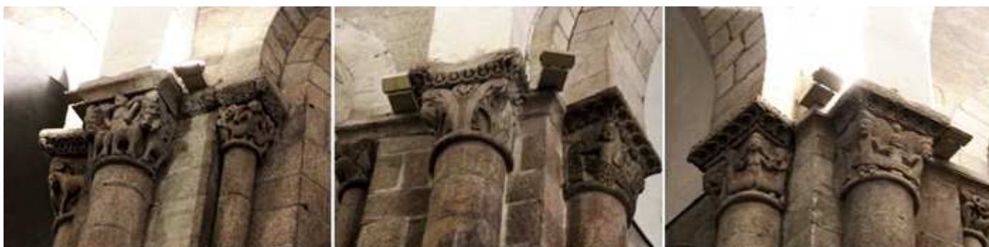
❶ Capiteles con personas entre animales y motivos vegetales. ❷ Las semi columnas redondas adosadas a las pilastras de los arcos. ❸ Donde salen los arcos de sección recta.
