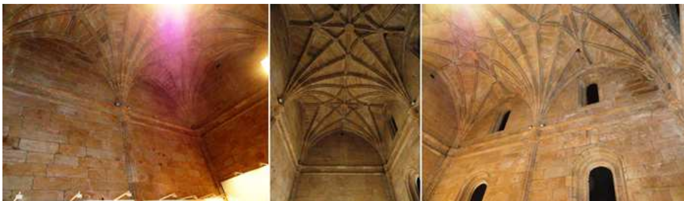
❶ Con semi columnas estriadas, con unas impostas corridas paralelas de donde nacen los nervios de la bóveda. ❷ Las bóvedas ocupan los dos tramos del vestíbulo. ❸ Uno de los laterales está abierto con ventanas.
