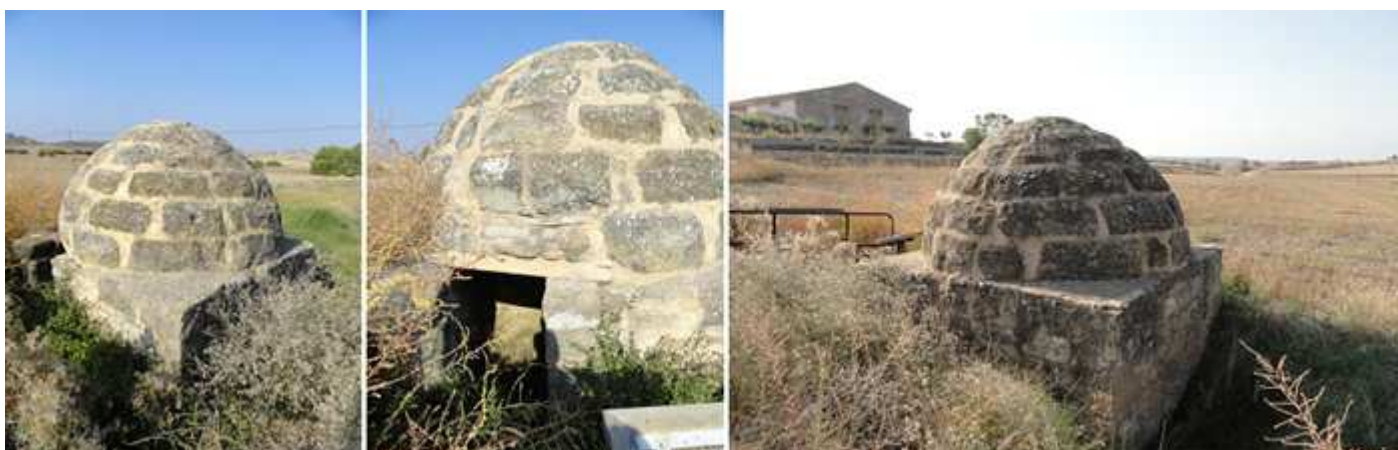
1 Es una estancia única de planta cuadrada. 2 Con una cúpula semicircular con una pequeña apertura adintelada. 3 En su interior cabrían unas cuatro personas, que se resguardaban en estos gruesos muros de piedra.
