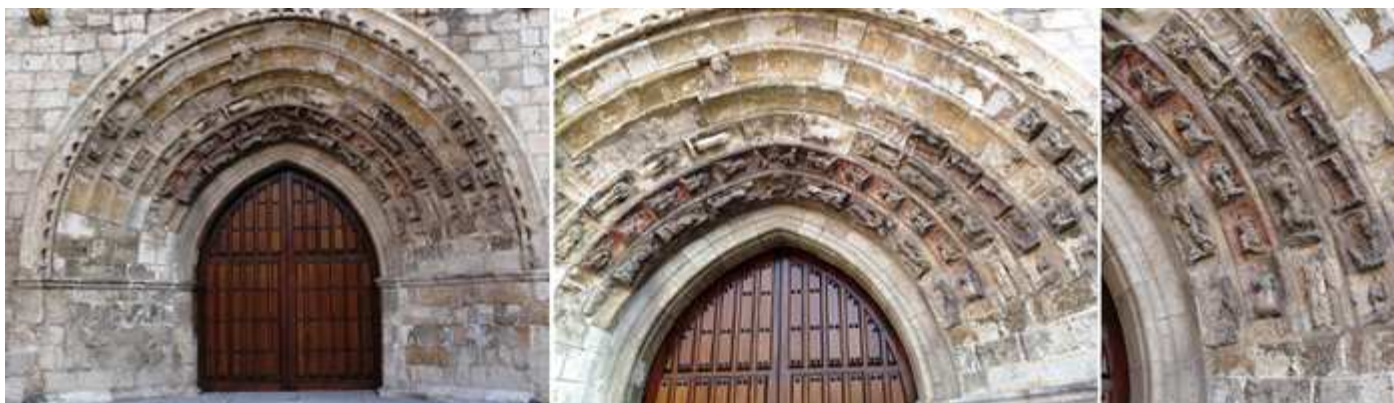
❶ Portada con un guardapolvo baquetonado y con arcuaciones a su interior, parte de las imágenes de sus arquivoltas se han perdido. ❷ Con un arco apuntado en su interior y una imposta corrida. ❸ Detalle de la parte derecha de la portada.
