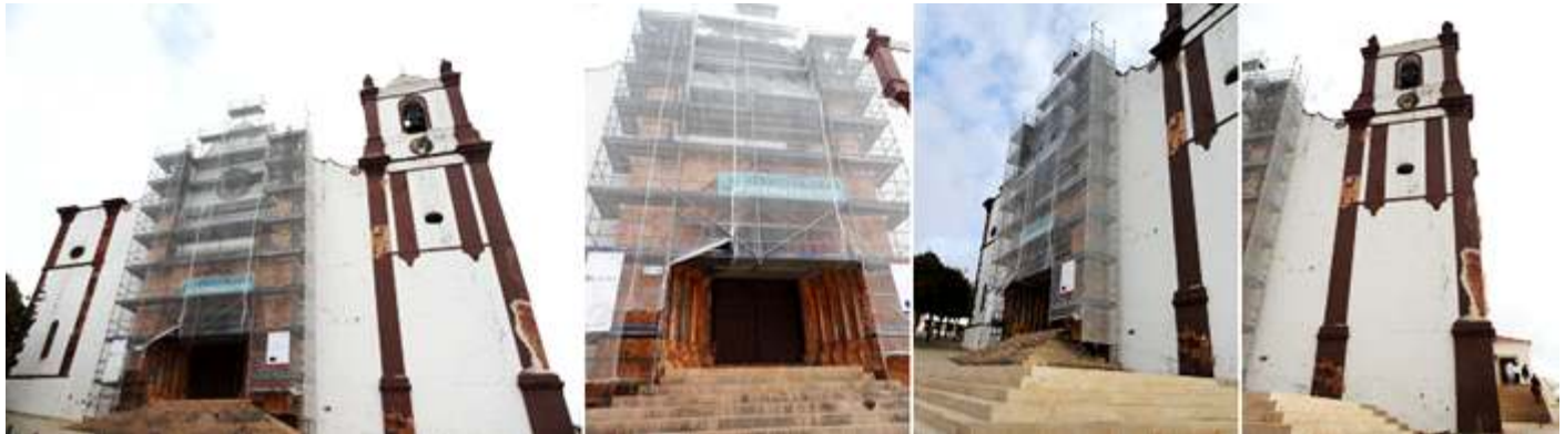
❶ Fachada principal donde se aprecia que una de sus torres está inacabada. ❷ Cubierta con las redes de la empresa que efectúa las obras. ❸ Y su torre del lado epistolar terminada.
