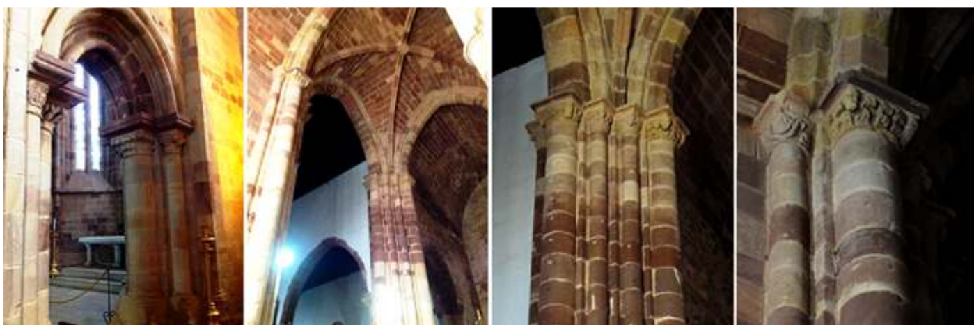
❶ Arco de medio punto con dos arquivoltas baquetonadas que descansan sobre una imposta corrida con tres capiteles y columnas y da paso a la capilla Mayor desde el ábside epistolar. ❷ Bóveda de Crucería simple en crucero de este lado. ❸ Grupo de columnas y capiteles de ábside epistolar con la nave central. ❹ Capiteles del ábside con motivos vegetales y caras humanas.
