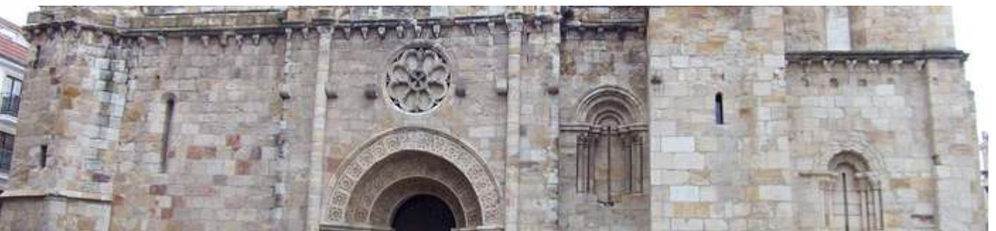
❶ Panorámica de la parte superior de la fachada con dos ventanas con arquivoltas y columnillas.
