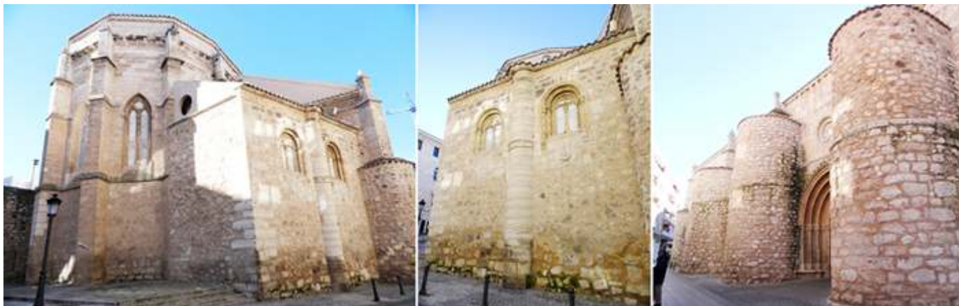
❶ Su cabecera poligonal con grandes contra fuertes y abierta con ventanas de arco apuntado. ❷ Lateral con ventanas ojivales pareadas, de la capilla de San Juan Bautista. ❸ En este lateral exterior del Evangelio se encuentra la puerta de la Umbría.
