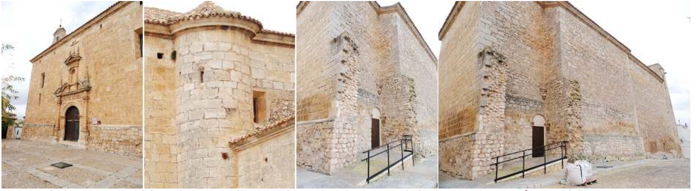
1 Portada ligeramente adelantada. 2 Escalera que hay adosada en este lado. 3 - 4 Dos imágenes del exterior del lado del Evangelio.
