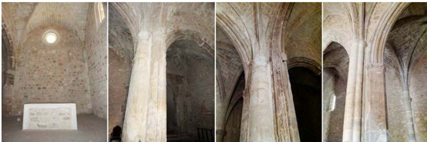
1 Detalle de la cabecera recta de esta nave. 2 Ejemplo de sus columnas agrupadas. 3 Otro detalle de las mismas. 4 Con bóvedas de crucería.
